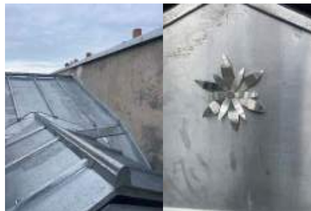
Copropriété du 69 boulevard Beaumarchais à Paris 3 ème – Réfection de la couverture en 2025
