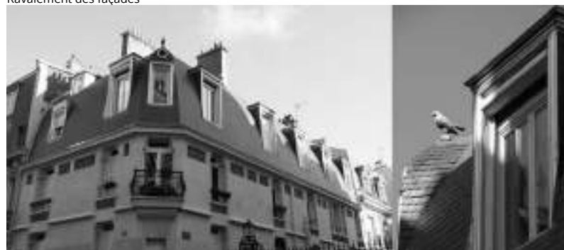
Immeuble 1 à 1 quart rue de Pomereu Paris 16° / Hôtel Particulier De Baudot Travaux de ravalement et réfection de la toiture
