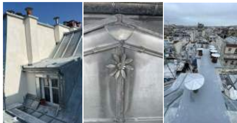
Copropriété du 84 rue du faubourg Saint Denis à Paris 10 ème – Couverture zinc en 2024
