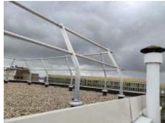
Copropriété du 102 avenue Aubert à VINCENNES - Réfection d'étanchéité avec création d'un garde-corps technique en 2021-2022
