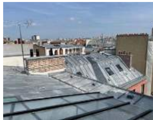
Copropriété du 118 rue de Turenne à Paris 3 ème - isolation en laine de bois de la couverture en zinc.
